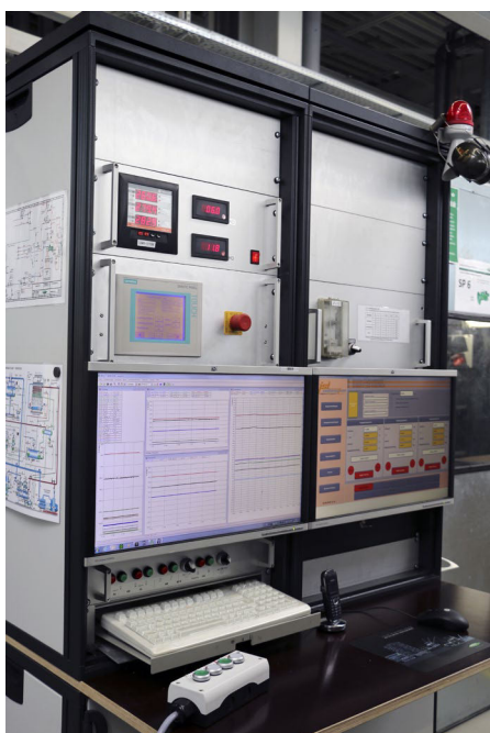
Das Prozessvisualisierungssystem Simatic WinCC (rechts) und die Messwerterfassung (links) laufen auf dem gleichen PC. Die Ventile werden wahlweise durch Regler oder manuell durch Taster angesteuert.
